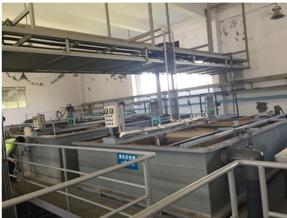
图4-2 废水处理设施
